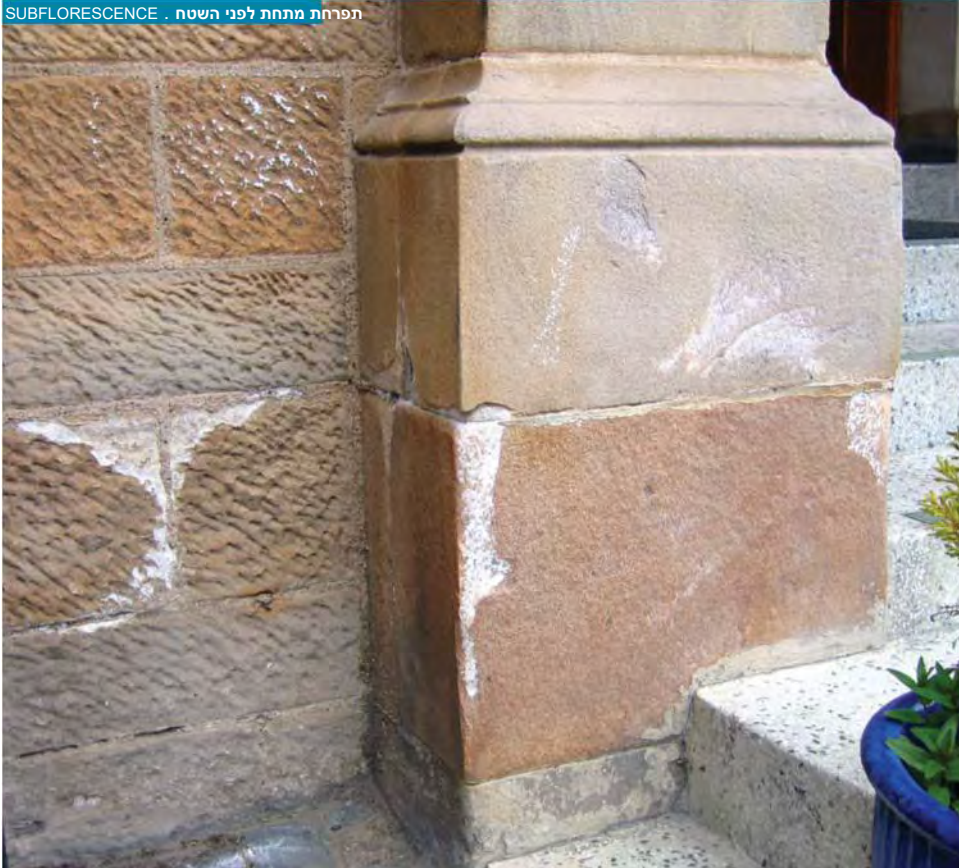
SUBFLORESCENCE . תפרחת מתחת לפני השטח
