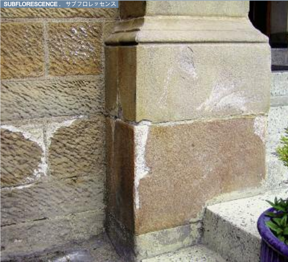
SUBFLORESCENCE . サブフロレッセンス
