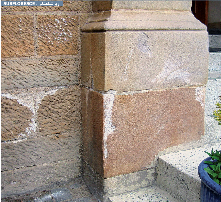
SUBFLORESCENCE . زیر شکفتگی
