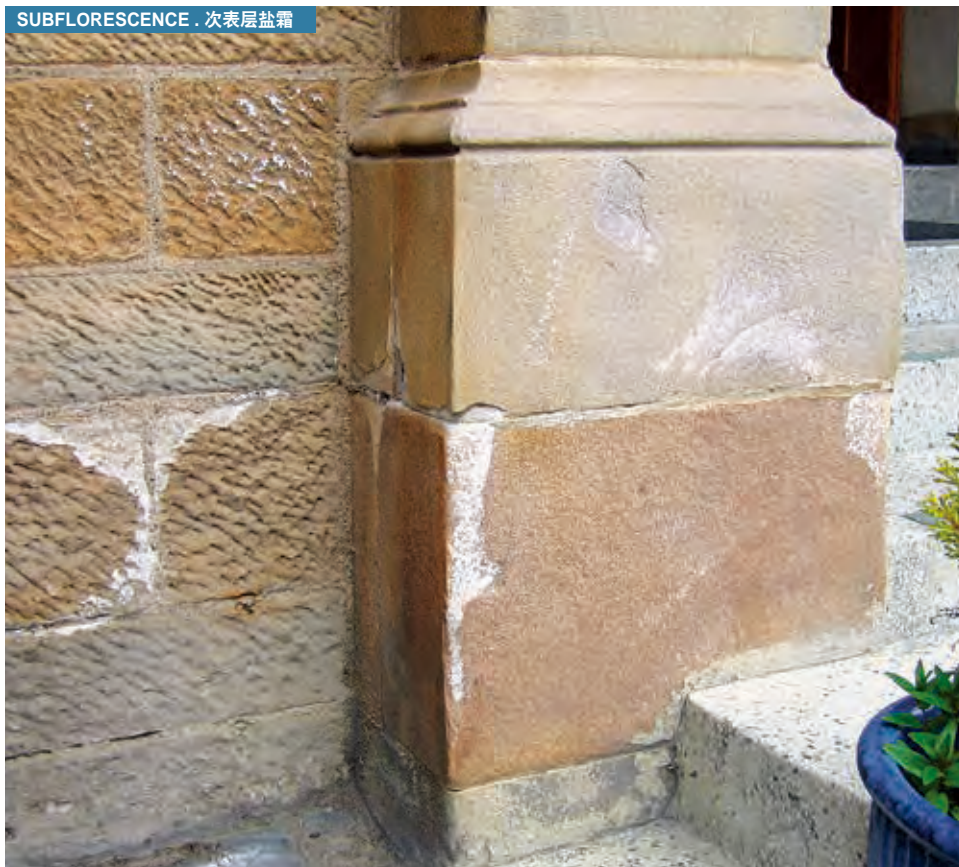
SUBFLORESCENCE . 次表层盐霜
