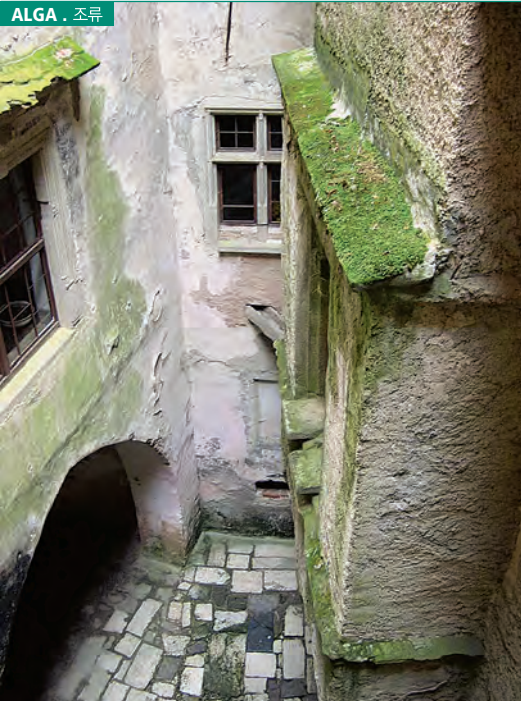
Green algae developing on a lime render on stone masonry. 석조건축물의 석회미장에 생긴 녹조류
